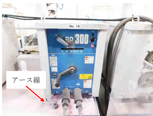
写真6 溶接機No.10の外箱の状況
