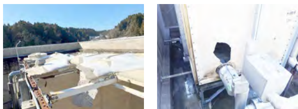
(1) パネル上部の破損 (2) 配管接続部の破損
