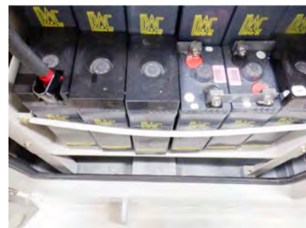
(2) 損傷したバッテリー
