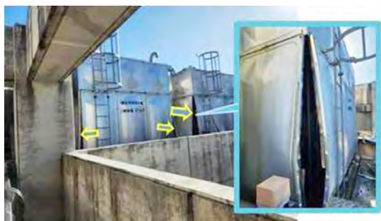
図2 屋上に設置された高置水槽の破損事例 1)
