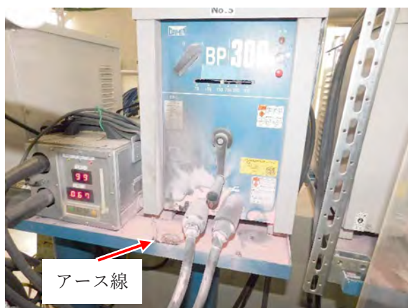
写真4 溶接機No.5の外箱の状況
