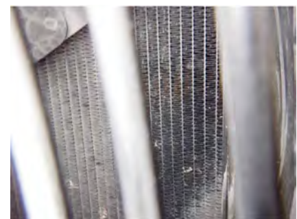
(3) 損傷したラジエター
