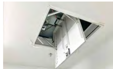
図10 地震により誤作動した排煙口 2)
