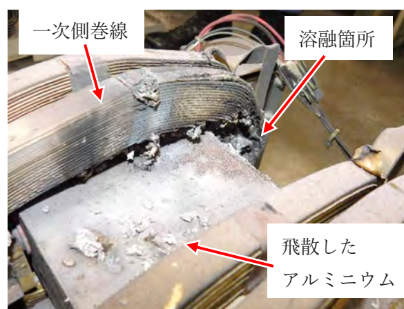
写真7 内部の変圧器部分の焼損状況
