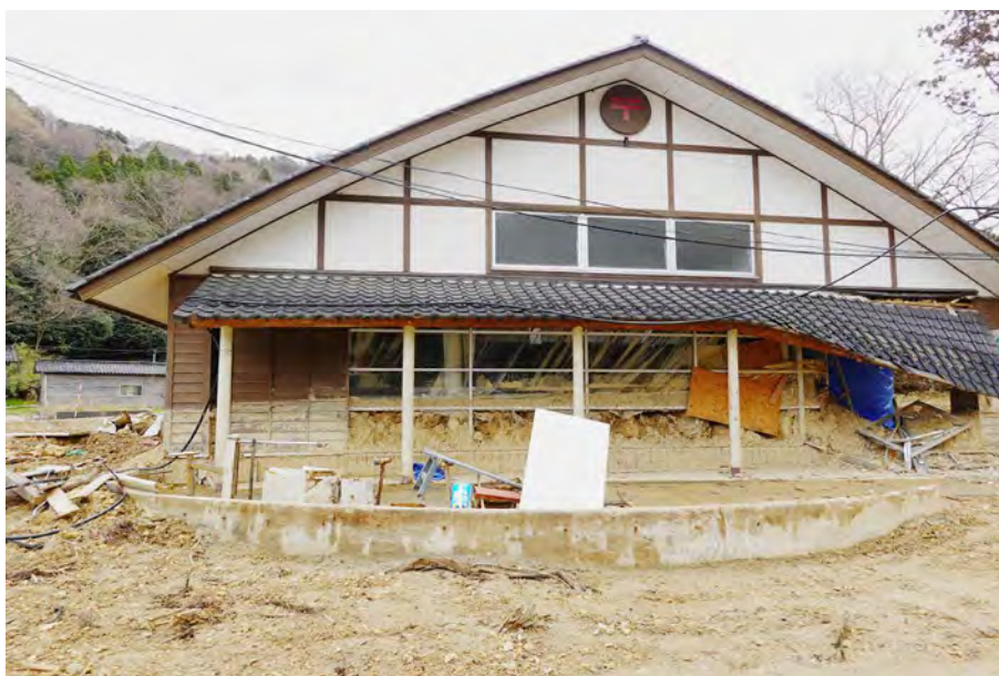
写真２ ９月の集中豪雨による被害（輪島市・大谷）
