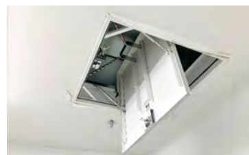
図10 地震により誤作動した排煙口 2)
