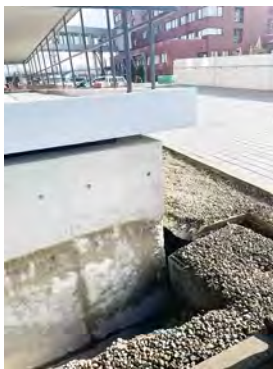
(1) 地盤沈下状況 2)
