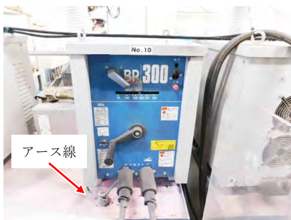
写真6 溶接機No.10の外箱の状況
