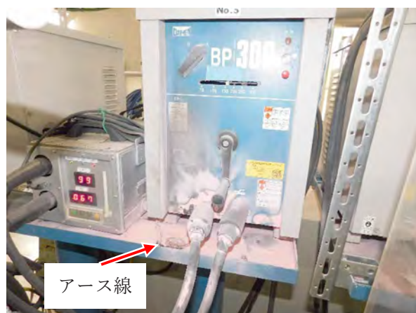
写真4 溶接機No.5の外箱の状況
