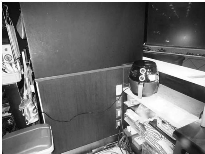
写真No. 5 フライヤーの出火時の状況
