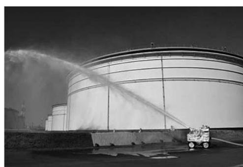
放水砲ロボットによる放水状況
