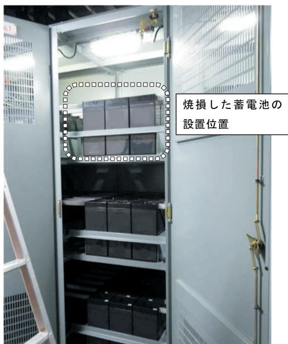
写真2 蓄電池設備盤内部の状況
