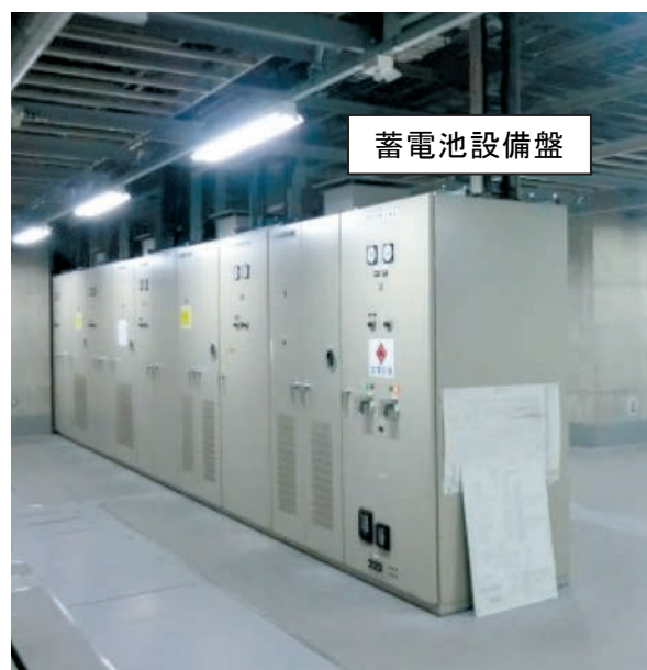
写真1 出火した電気室の状況
