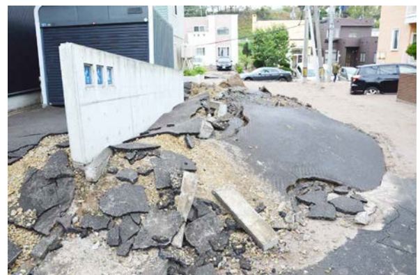
写真-6 被災地の状況（地点 e）
