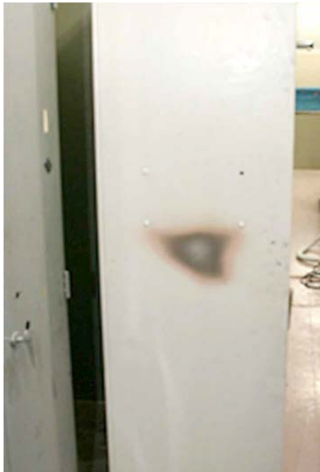
【写真2 焼損したキャビネットの側面】
