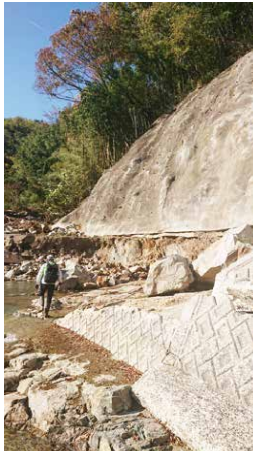
筆甫地区への主要道崩落の様子 写真提供：宮城県丸森町役場
