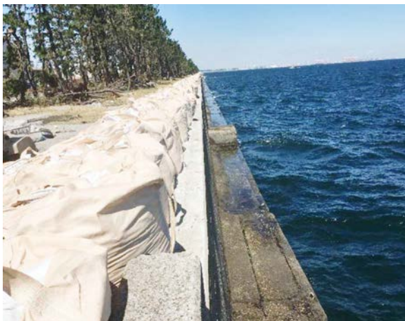
図-6 横浜市福浦地区での護岸の被災
