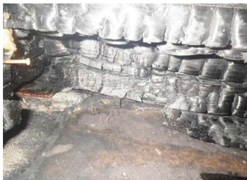
写真9 モルタル壁変色箇所
