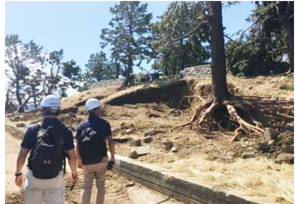
図-7 波浪により侵食された斜面
