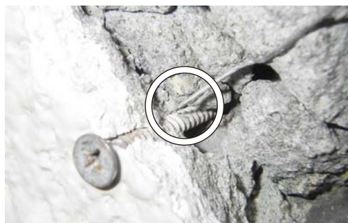
写真15 ネジとワイヤーラスの状況
