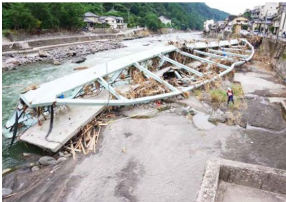
写真2 新天ヶ瀬橋の落橋
