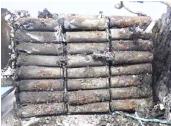
写真9 リチウムイオン電池の状況
