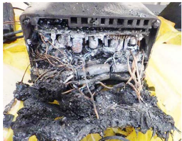
写真11 ポータブル電源上部の状況
