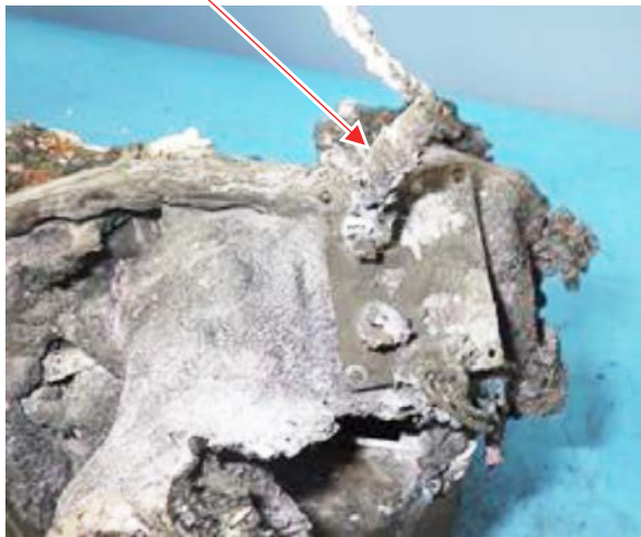
写真8 DC12V出力ポートの状況
