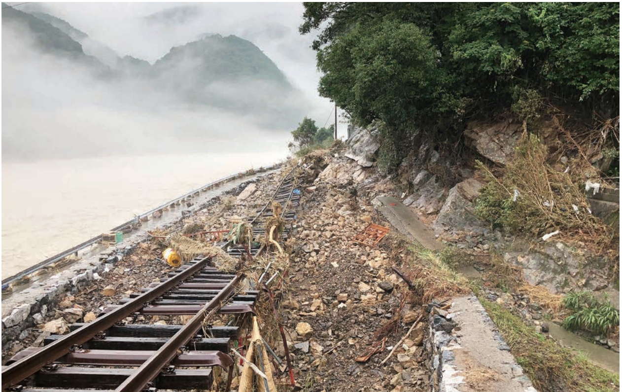
八代市豪雨の爪痕：鉄道被害の様子 写真提供：熊本県八代市
