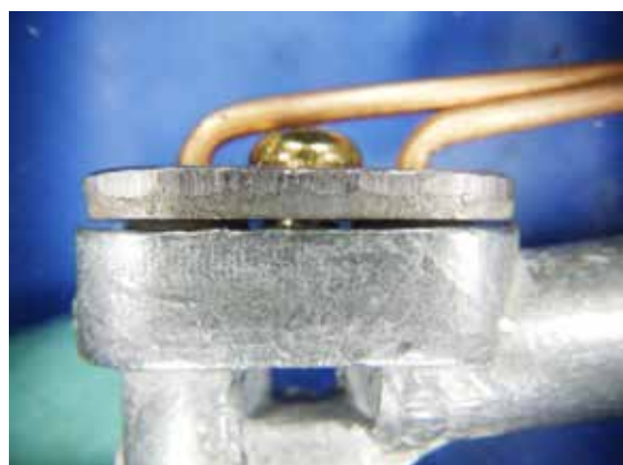
写真5 焼損品のパイプ接続部
