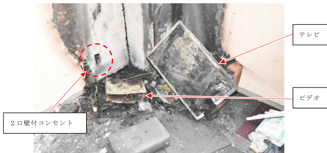
【出火箇所の状況】
