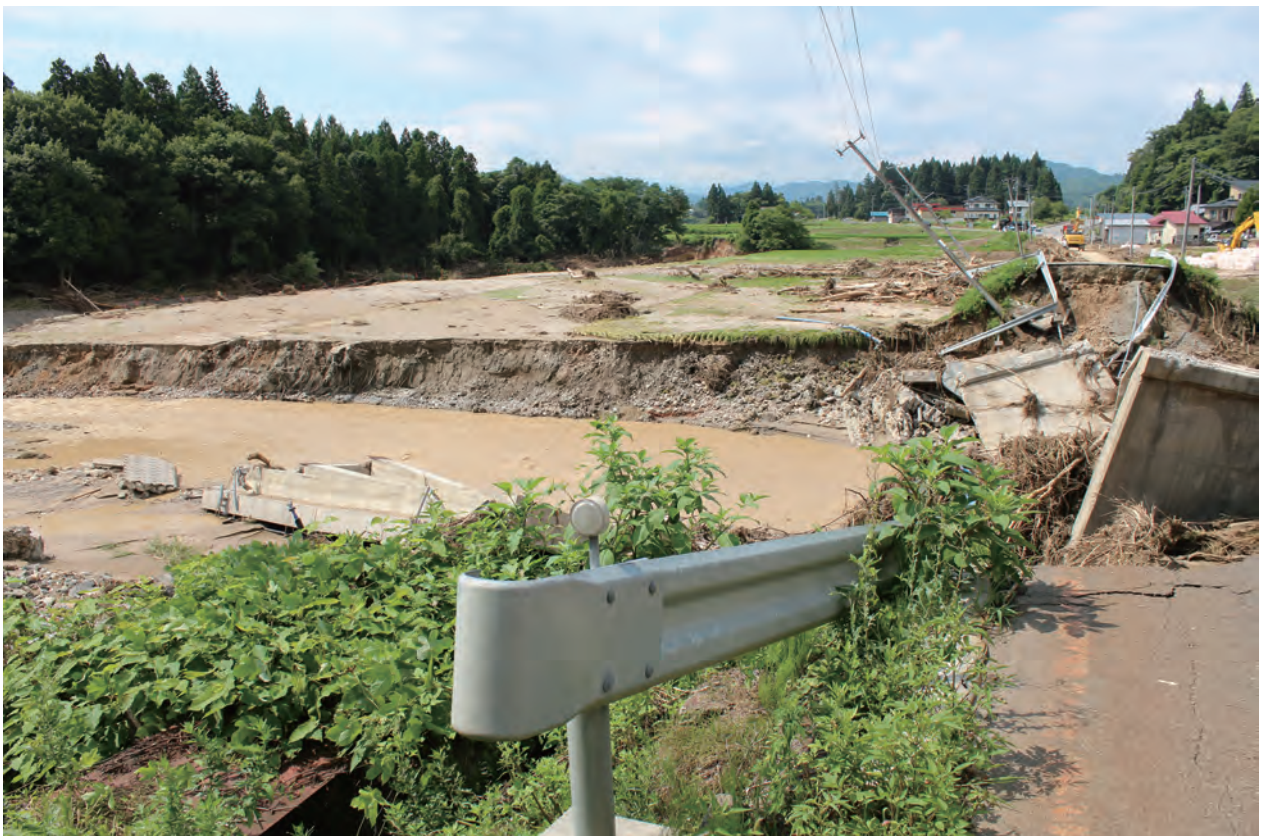
山形県飯豊町 - 白川にかかる大巻橋の崩落現場（2022年8月撮影）
