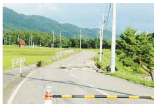
図5 陥没した道路（湯沢地区）
