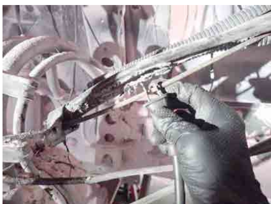
写真8 漏電立証時の状況（出火点）
