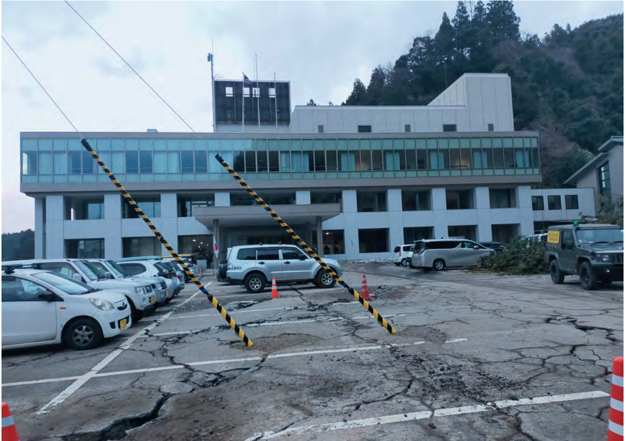
石川県穴水町（役場）：地震により多数の亀裂が走った駐車場（2024年1月5日撮影）
