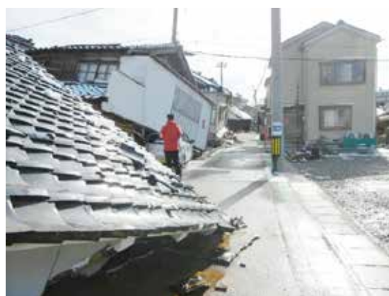
倒壊した木造家屋（輪島市）
