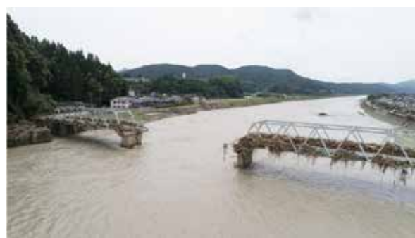
流出した西瀬橋（人吉市）
