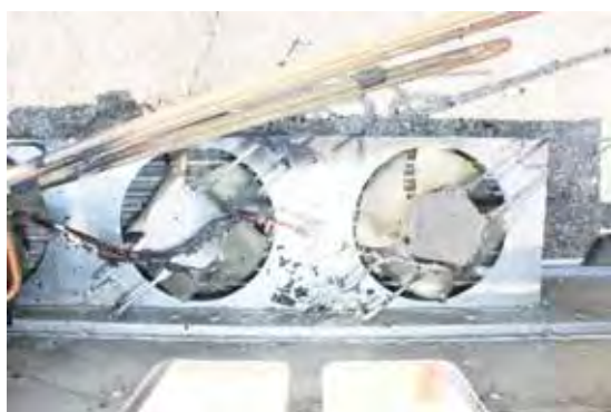
(写真8) コンデンスファンの状況
