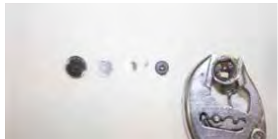
(写真17) サーモスタット（同型品）の状況
