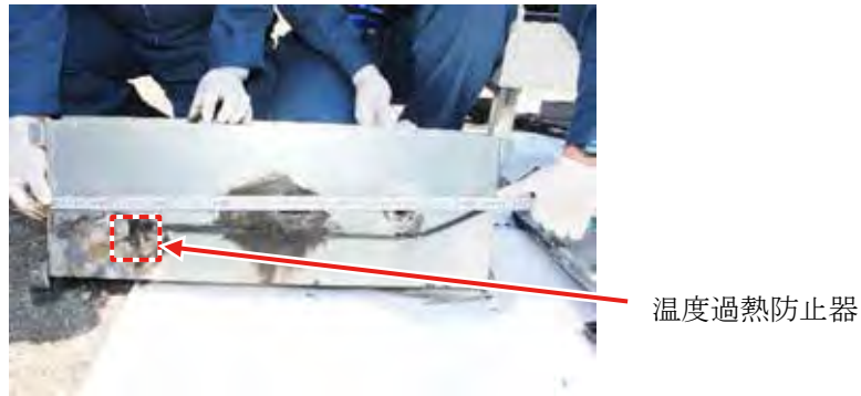
(写真11) 蒸発皿２段目底面（裏面）の状況
