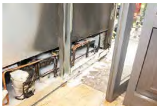
（写真1）冷蔵ショーケースの状況
