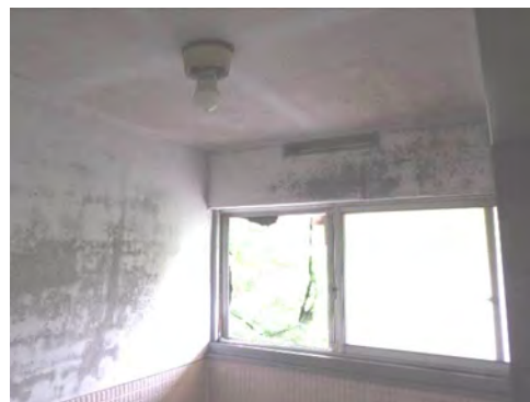
写真1 浴室の状況①
