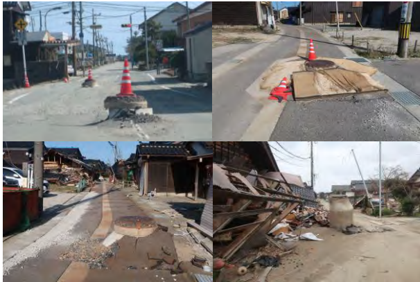
図2 車道路面に突出したマンホール
