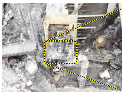
写真5 居室東側角ヒューズコック周囲
