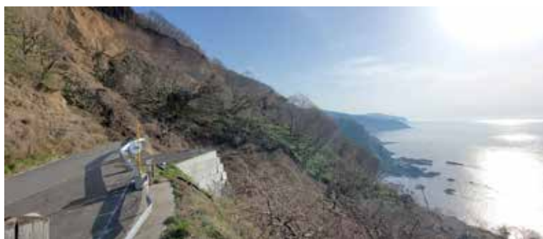
写真3 地すべりによって崩壊した道路（輪島市ゾウゾウ鼻付近：2024年4月7日青木撮影） 地すべりの移動体の下方に崩壊した道路（路面、電柱、ガードレール）が見える
