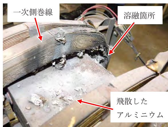
写真7 内部の変圧器部分の焼損状況
