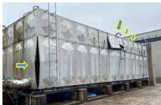
図 1 能登半島地震による受水槽の破損事例 1)
