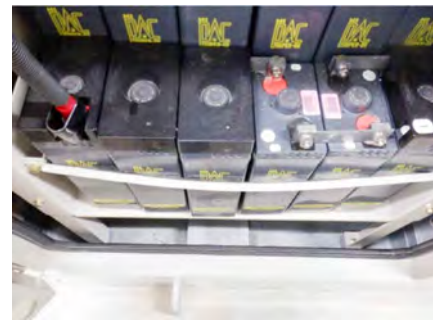
(2) 損傷したバッテリー
