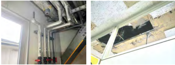
図7 地震で断裂した配管 2)
