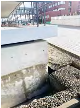
(1) 地盤沈下状況 2)
