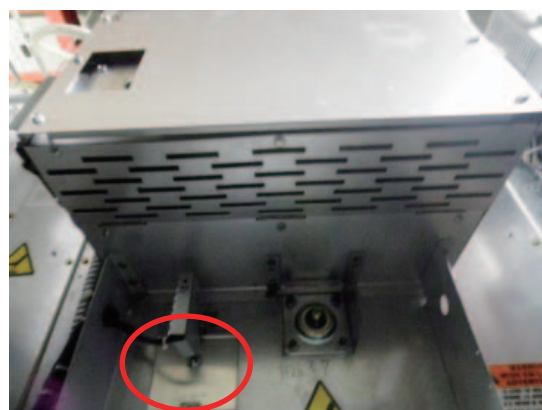
写真12 エアフローダンパー
