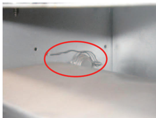
写真8 燃焼室リミットサーモの熱電対
