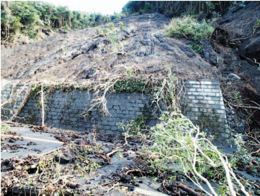
図4 崩壊発生源の一つ
