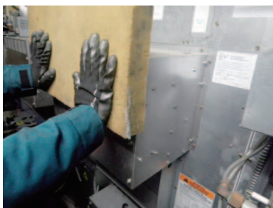
写真14 上のみ排気不良の再現
