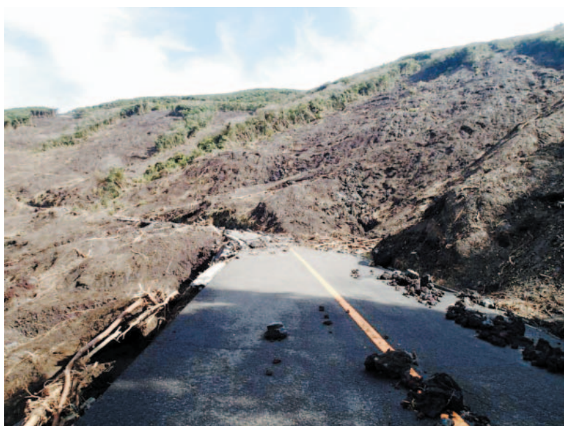
図5 崩壊発生源内を走る道路
