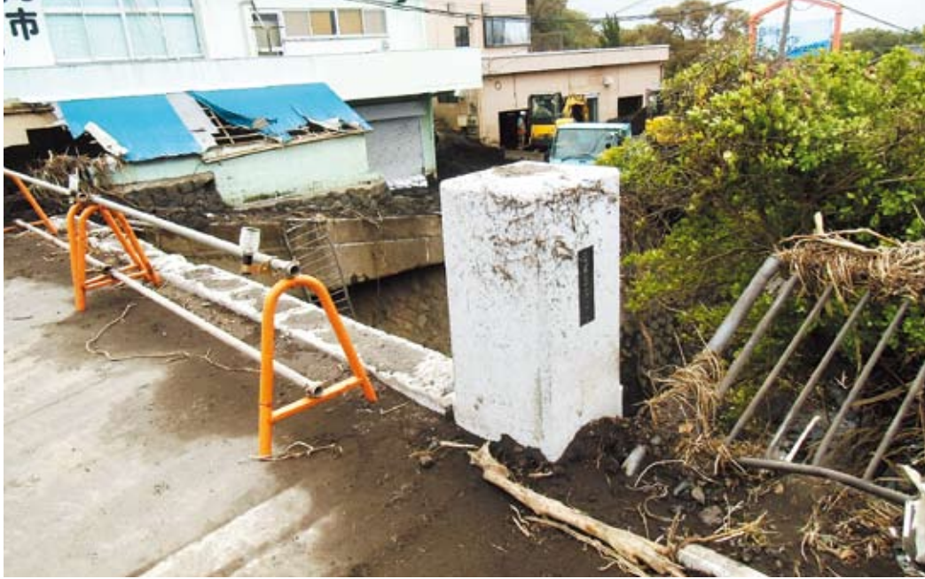
大島町の土砂災害の様子 (平成25年10月23日撮影)
