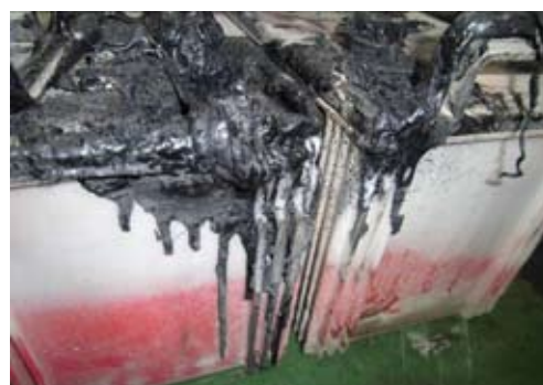
写真6 バッテリー側面（D P F 排気管側）
