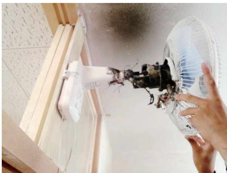
扇風機の焼損状況
