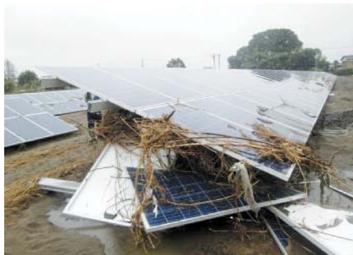
図7 現場付近の太陽光発電機器の被害
