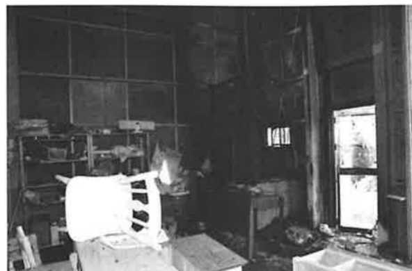
作業場内の焼損状況
