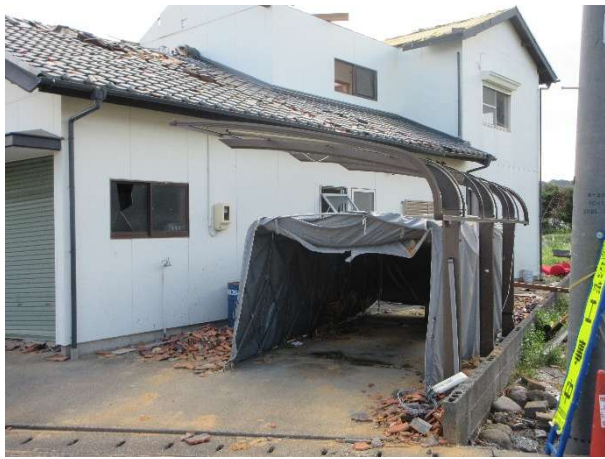
強風で落下したガレージ
