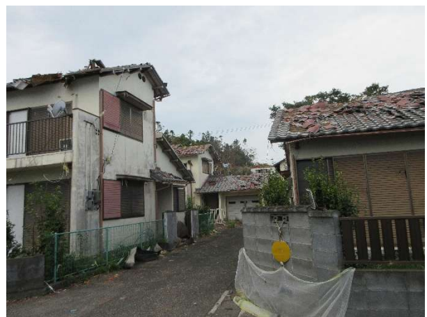
瓦が吹き飛ばされた住宅 ブルーシートが覆いかぶされておらず、復旧が 追い付いていなかった
