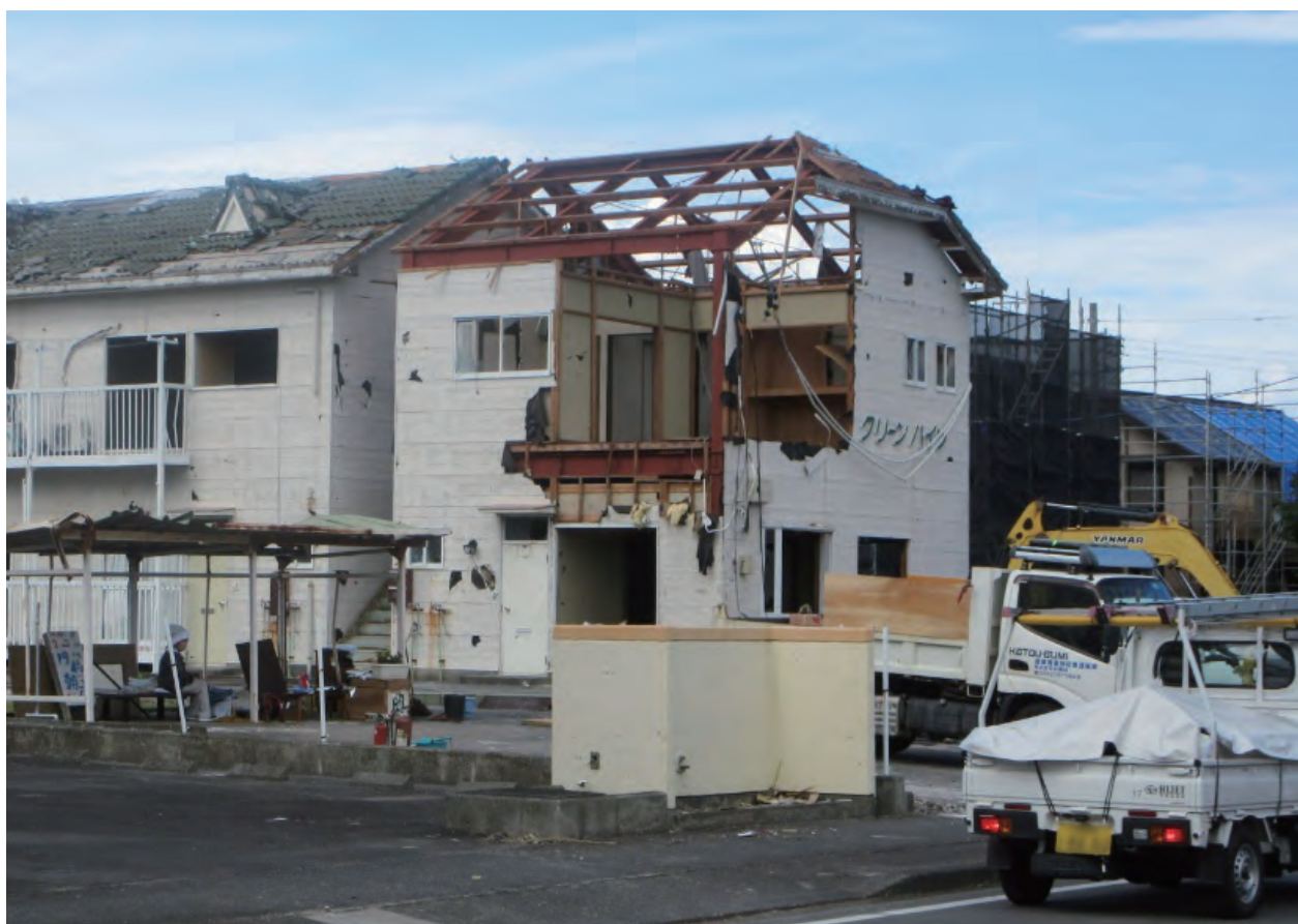
竜巻により被害を受けた建物（静岡県牧之原市細江付近、令和7年9月撮影）
