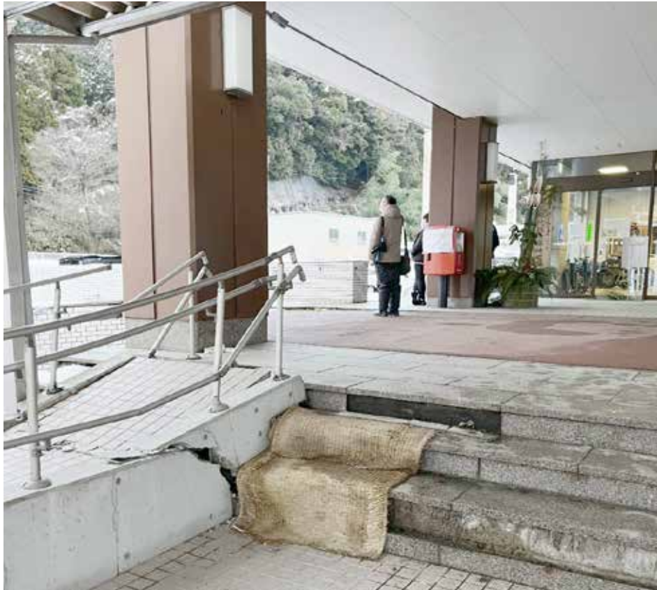
(図2) 地震で隆起した穴水総合病院
