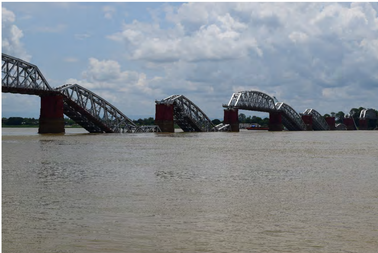
2025 年ミャンマー大地震により倒壊したアヴァ橋（出典：本誌 40 ページ掲載）
